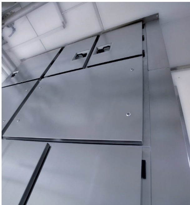
Eben, dicht und lebensmittelecht: die Verbindungen der verschiedenen Anlageteile
